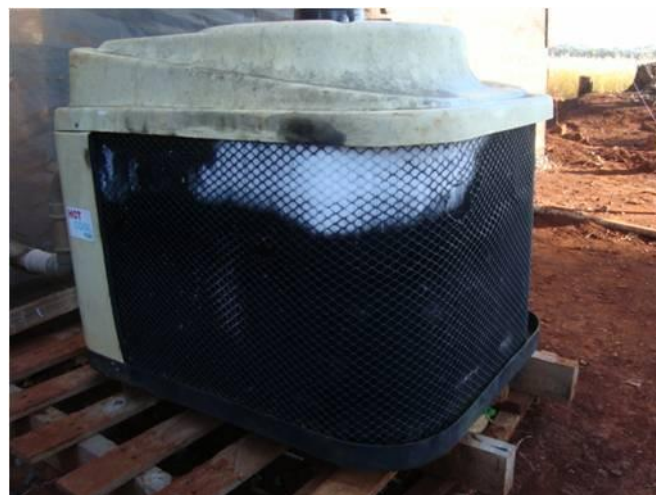
Figura 10. Congelamento do evaporador da bomba de calor no inverno.
